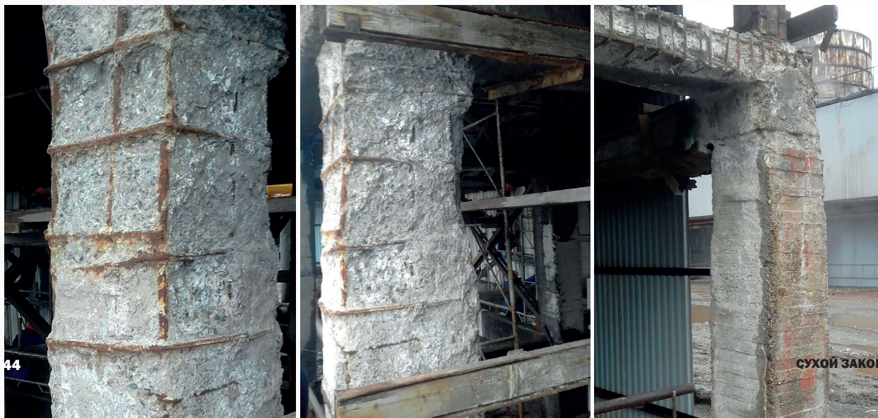
Разрушенная «колоннада» над чашей градирни
