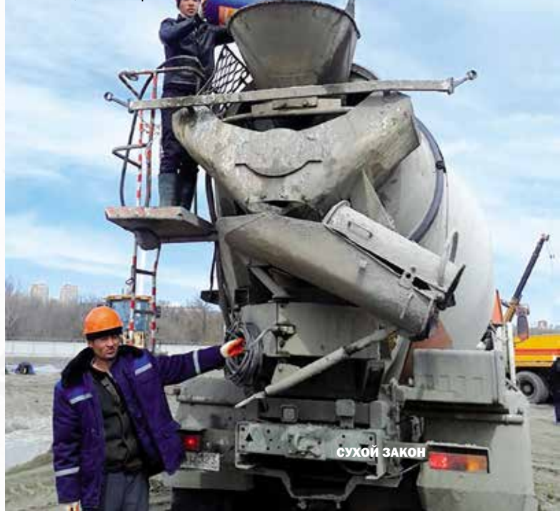
Заливка ростверка фундамента, введение добавки в бетон «Пенетрон Адмикс»: блок «Б», 1-й сектор
