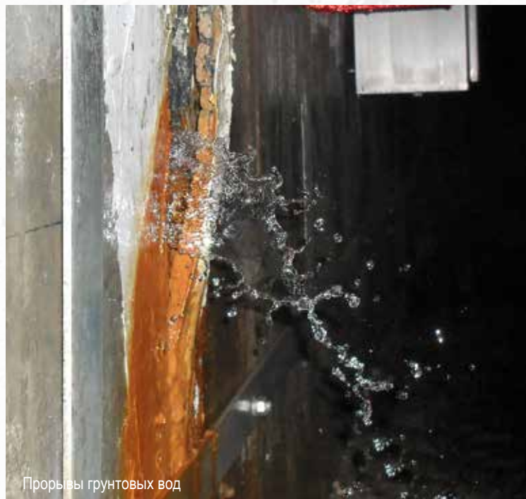
Последствия негодной гидроизоляции
