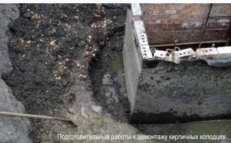
Колодцы из кирпича с обмазочной гидроизоляцией заполнены грунтовыми водами
