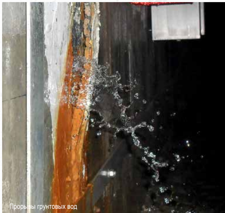
Последствия негодной гидроизоляции
