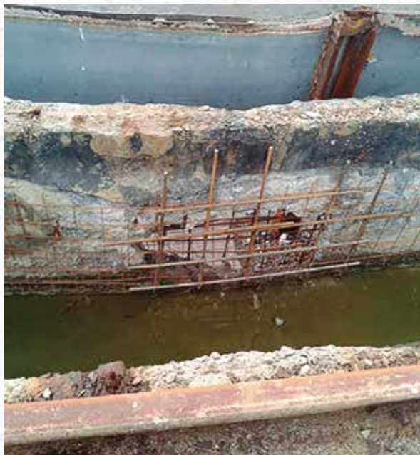
Рисунок 4. Разрушение защитного слоя бетона в результате морозной деструкции
