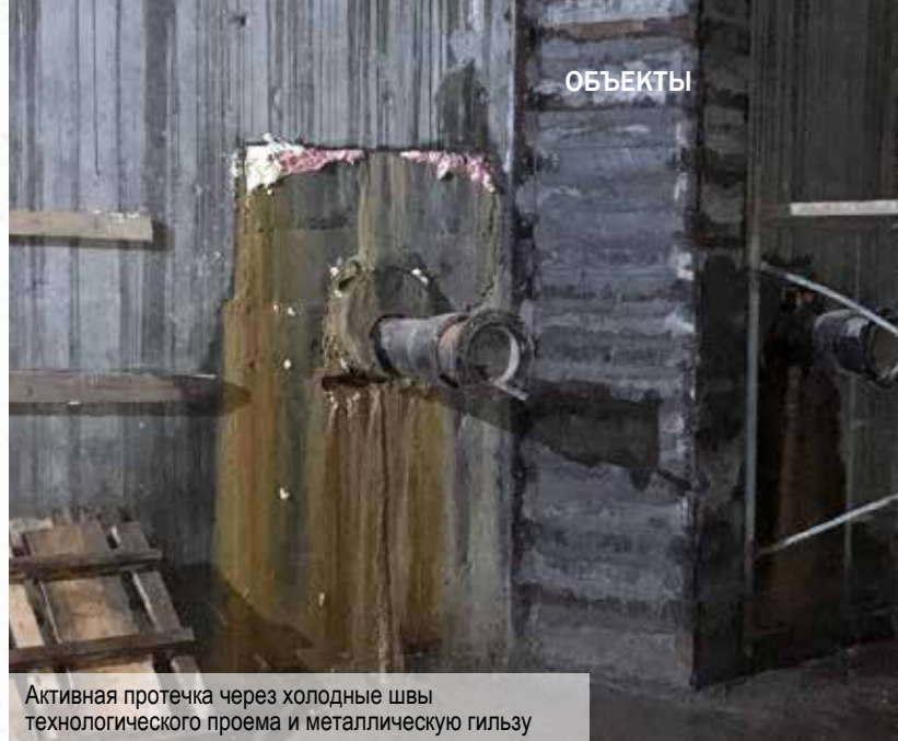
Активная протечка через металлическую гильзу в примыкании с бетоном
