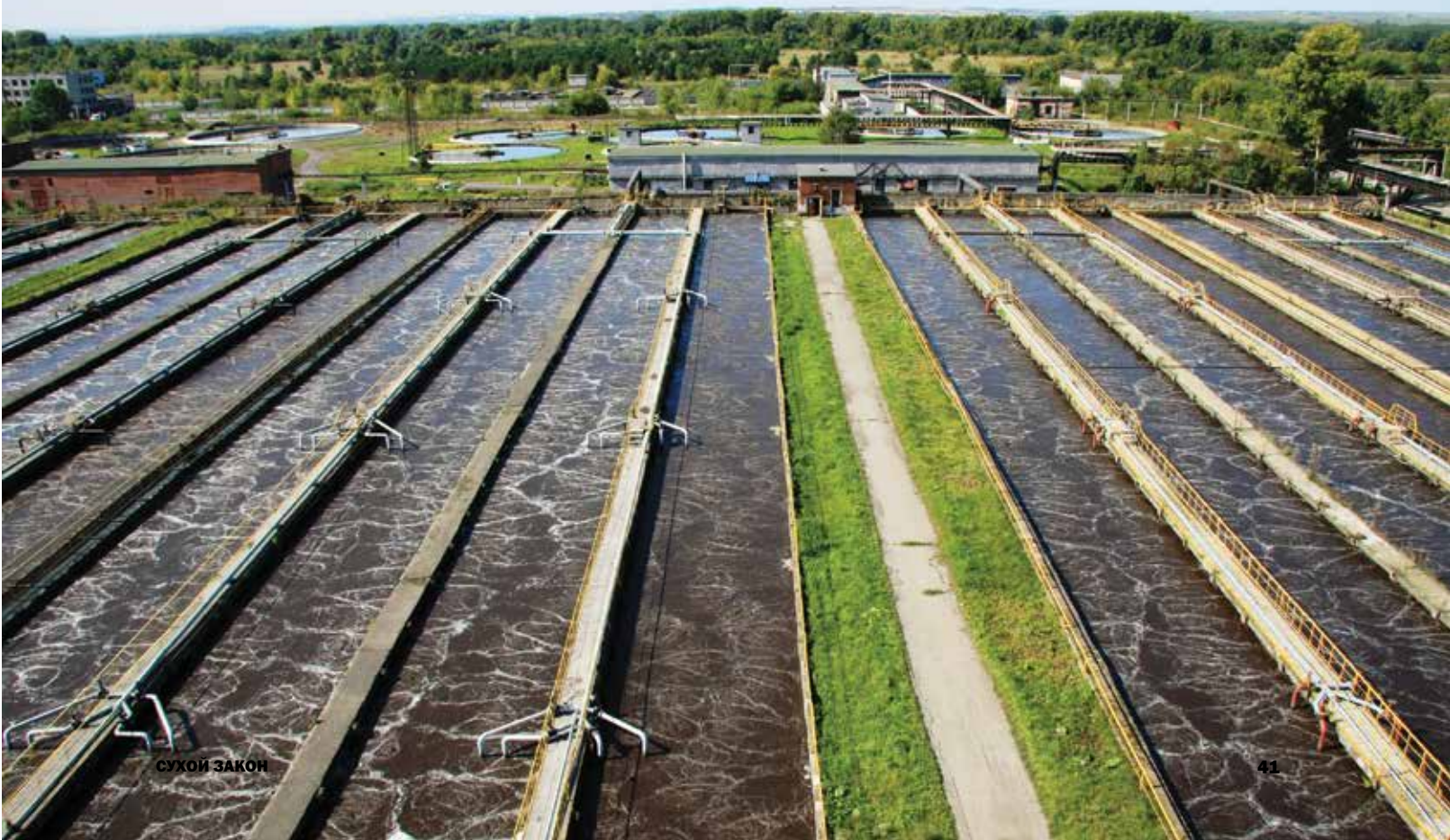
Очистные сооружения, г. Новокузнецк
