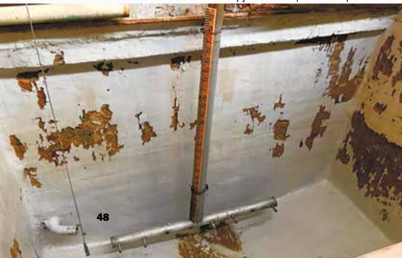
Рис. 1. Разрушение защитного покрытия баков
