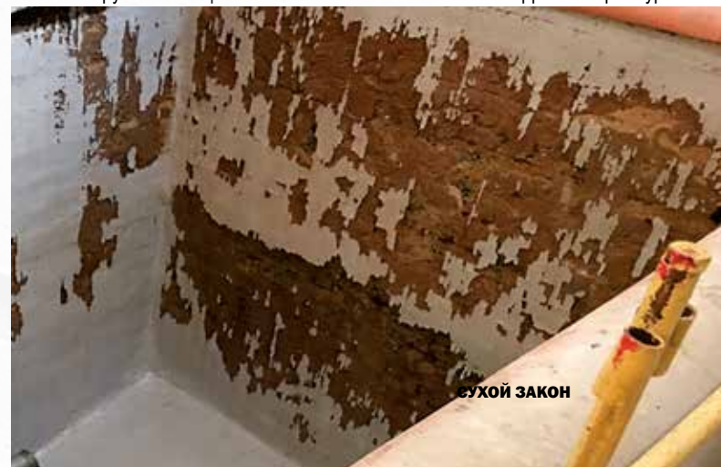
Рис. 2. Разрушение защитного слоя бетона с оголением и коррозией арматуры
