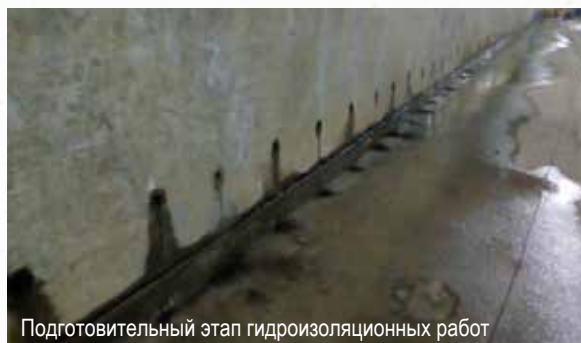
Локальные течи через тело бетона
