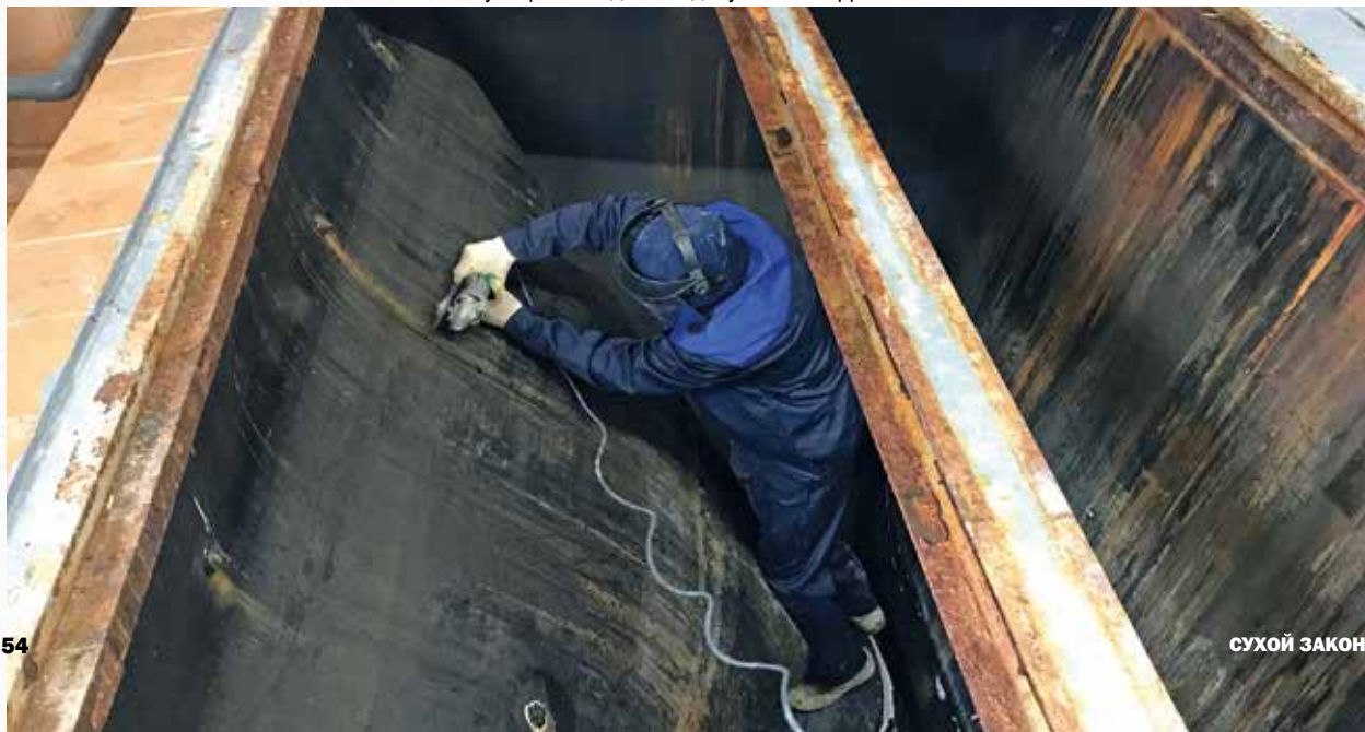
Бункер со следами недопустимой коррозии
