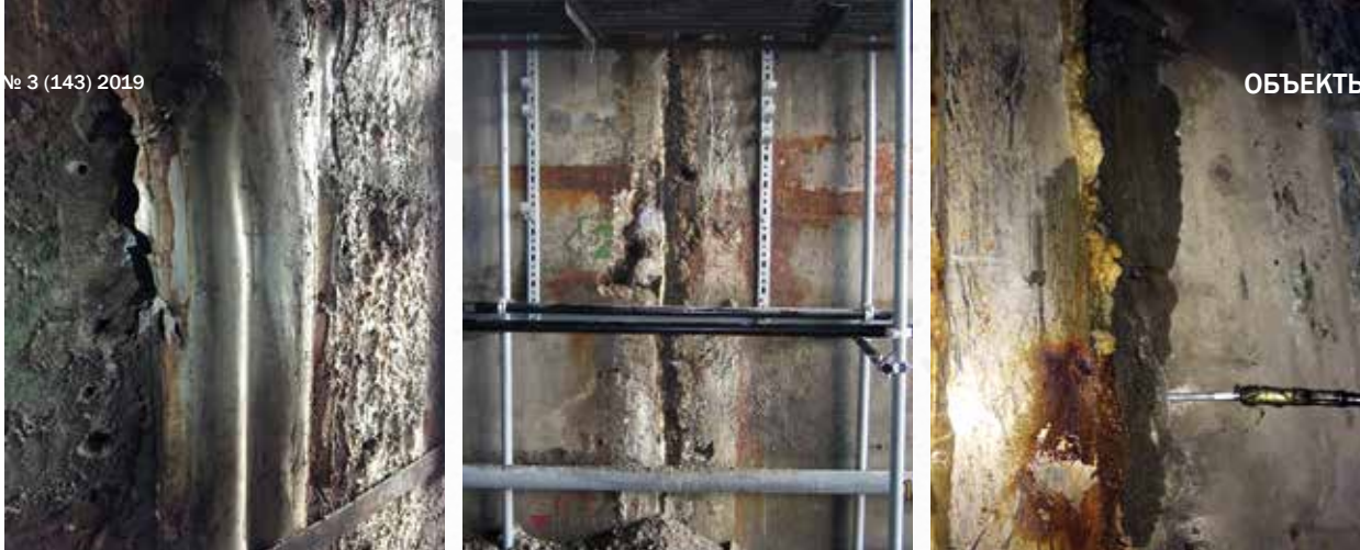
Следы глубокой коррозии железобетонных конструкций
