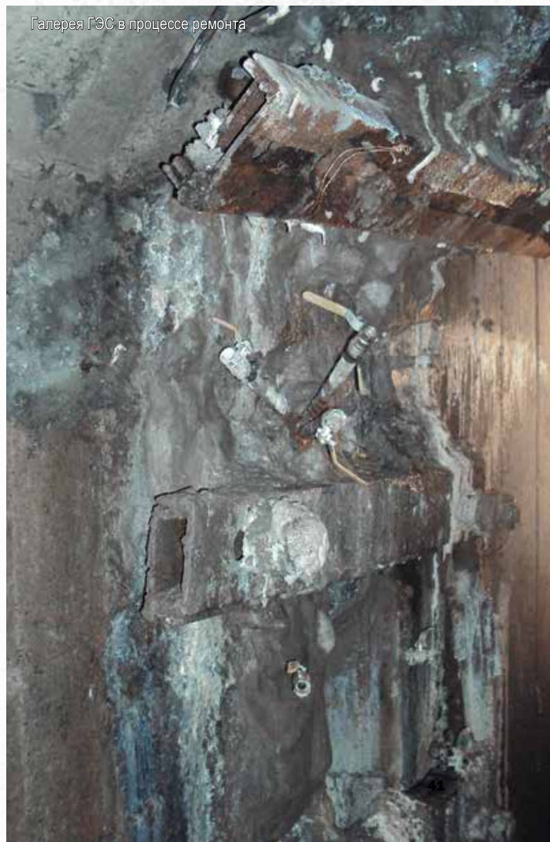
Напорные течи в галерее ГЭС
