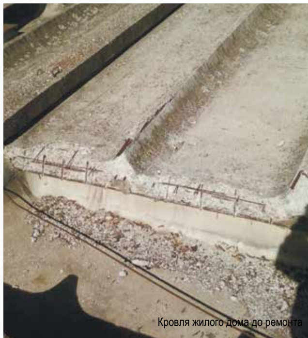
Разрушение ж/б панелей лотковой кровли
