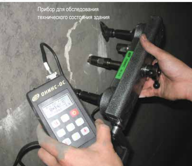
Дефектный участок бетонной поверхности
