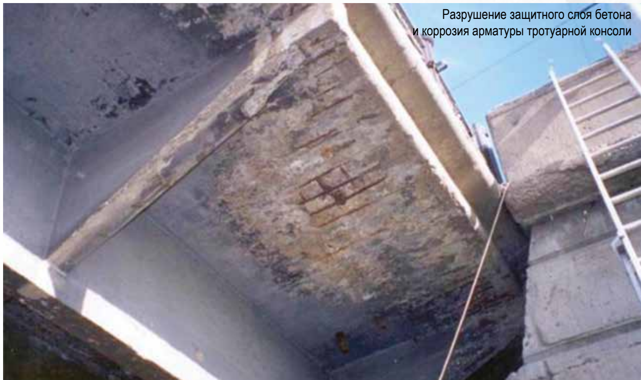
Консоль плиты проезжей части. Разрушение защитного слоя и коррозия арматуры
